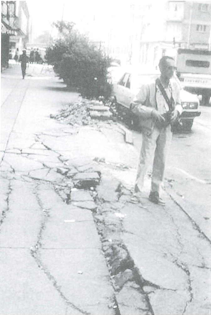
El suelo sobre el que está asentada esta calle, es más blando que ella. Al moverse éste, el asfalto, más rígido, se ha agrietado.
